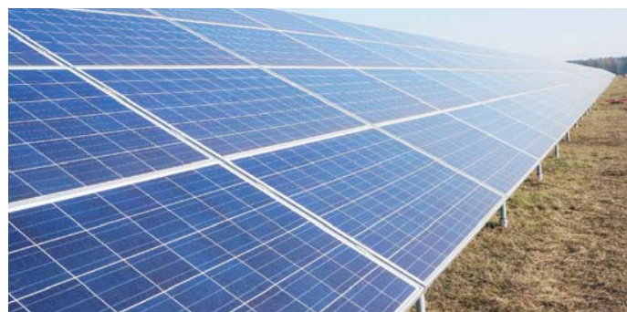
Testy i próba technologiczna elektrowni fotowoltaicznej w Gryżlinach zakończyły się pozytywnie
